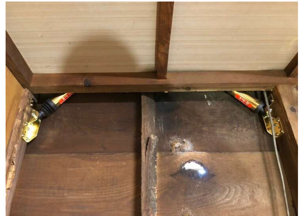
天井付近：免振ダンパー28 か所設置
